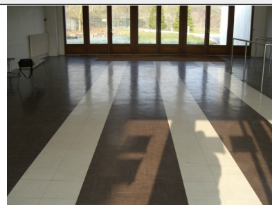
Dalles de sol amiantées
