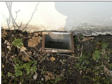
Ventilation VS en amiante ciment
