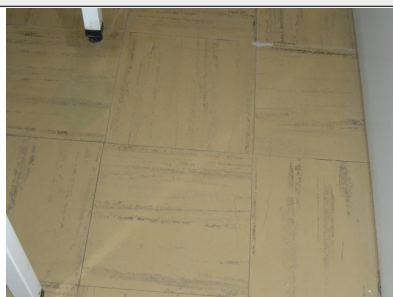
Dalles de sol amiantées
