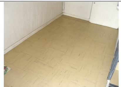
Dalles de sol amiantées
